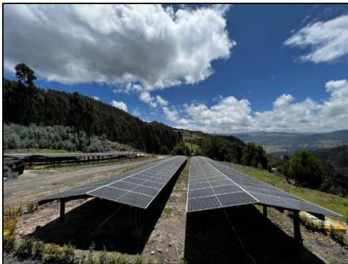
Fuente: Parque Solar CARBOING- Samacá Boyacá
